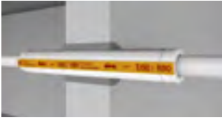
Brennbare Trinkwasser- und Heizungsleitungen
