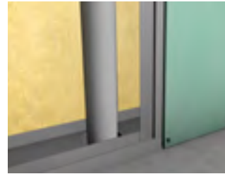
Abwasserleitung in der Vorwand
