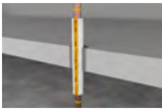
Rohr blank z. B. Gasleitung ohne Weiterdämmung
