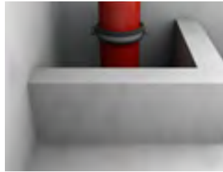
Abwasserleitung im Installationschacht
