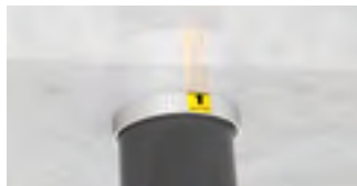
Brennbare Ab- und innenliegende Regenwasserleitungen
