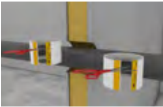
Anlegen der BSM-KR: Bei dünnen Wänden (100–170 mm) beide Brandschutz-Dämm-Manschetten oberhalb des Blähmaterials kürzen.
