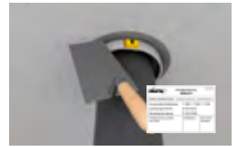
Brandsicherer Verschluss und Kennzeichnung.
