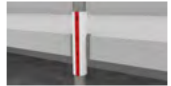
Nicht brennbare Lüftungsleitungen
