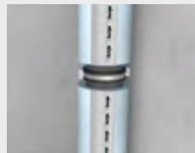
Abwasserleitung mit Misselon-Robust Regen gedämmt.
