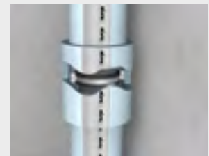
Überdämmung Rohrschelle mit Formteil.
