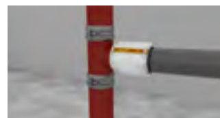
Übergang Guss-Kunststoff-Abwasserleitungen frei im Raum
